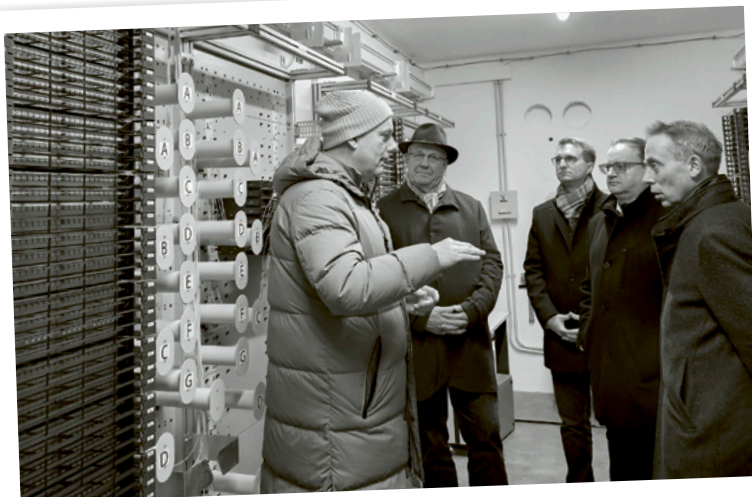
Im Bild (v.l.): Ralph Wehberg (Head of Deployment bei UGG), Christian Lindinger, MdL (Freie Wähler), Tobias Kurz, Erster Bürgermeister von Bad Füssing, Stefan Meyer, MdL (CSU) und Hans Koller, stellvertretender Landrat.
